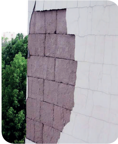
Рис. 8.1. Пошкодження штукатурки на фасаді будинку
