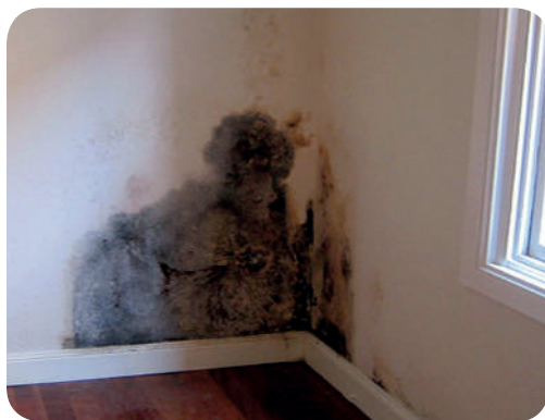
Рис. 7.11. Грибок на оштукатуреній поверхні
