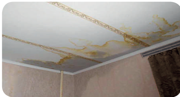
Рис. 7.13. Плями і сліди від підтікань на оштукатуреній поверхні
