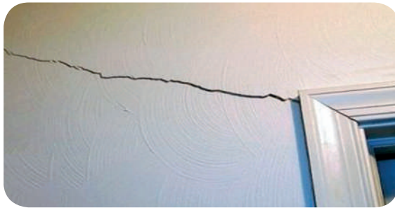
Рис. 7.14. Тріщини на оштукатуреній поверхні
